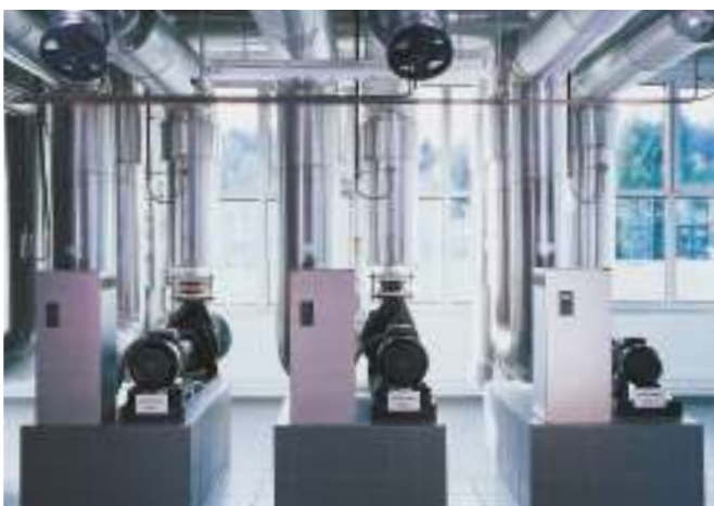
Котловые циркуляционные насосы с частотным регулированием
